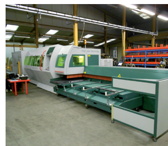
Le laser installé et opérationnel.
